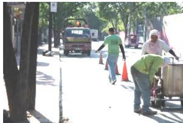
自転車道の整備
